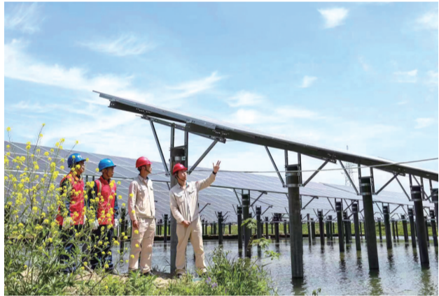
肥东县八斗镇渔光互补光伏发电项目
