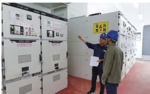
国网池州市贵池区供电公司作业人员检查企业用电设备。韩亚东/摄
