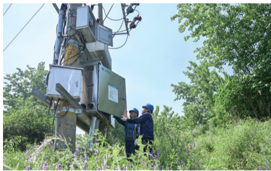
工作人员在对配电箱内的漏电保护器进行检测
