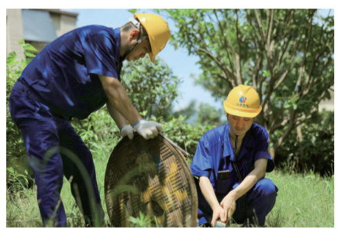
合肥燃气集团工作人员头顶烈日检查燃气管道。 左娟娟 孙雨静 记者 沈娟娟/图
