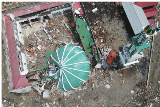
图为10月8日在印度尼西亚中苏拉威西省帕卢航拍的倒塌房屋。印尼抗灾署的最新数据显示,这场灾难已造成近2000人死亡,约2500人重伤,近7万座房屋损毁,数万人被迫撤离家园。这是过去5年来印尼发生的最严重的自然灾害。 □ 新华社发
