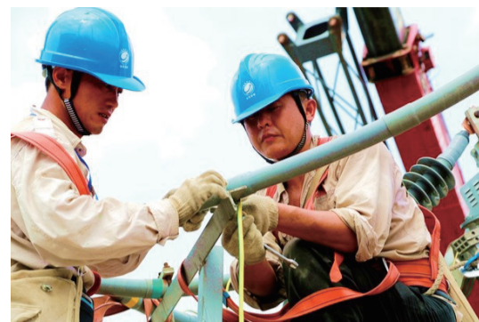
高温肆虐,居民用电负荷的大幅攀升,给供电线路带来极大的考验。在长丰县杜集镇羊荒村的施工现场,长丰县供电公司近50名员工正在紧锣密鼓地对35千伏朱杜线和杜造线进行着线路改造工作。经过此次改造,将极大地改善朱杜线和杜造线的运行能力,缓解杜集镇今夏的用电负荷压力。 □ 张凯棋 记者 汪婷婷 文/图
