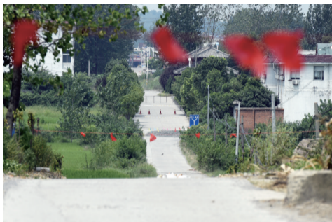
远处可见一条笔直的道路中间发生明显下陷
