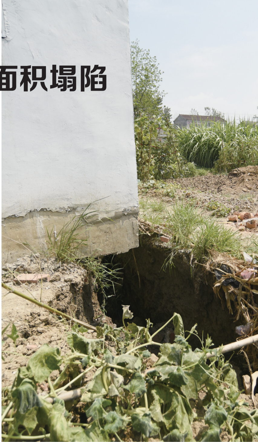
塌陷核心区一栋建筑的地基一侧土地完全下陷
