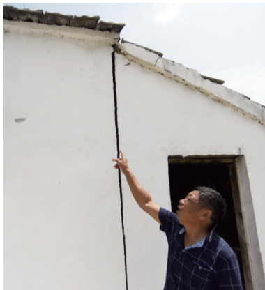
警戒线外围的村民家房屋围墙开裂
