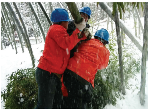
1月29日,宣城市广德县供电公司在誓节余家台区清障抢修,确保线路安全。 ■ 余小祥 记者 曹开发/图
