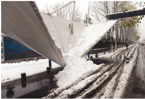
位于黄山路与合作化路交口的车棚坍塌
