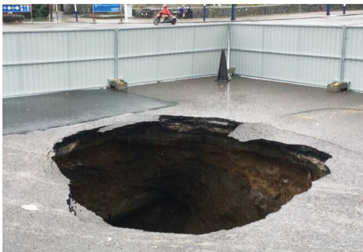
路面塌陷现场
