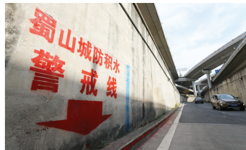
昨日，合肥市蜀山区市政人员在五里墩立交桥一低洼下穿匝道施划积水警戒线。确保积水内涝及时发现、快速处置，保障车辆、行人通行安全，提升城市内涝防范和应对能力。
