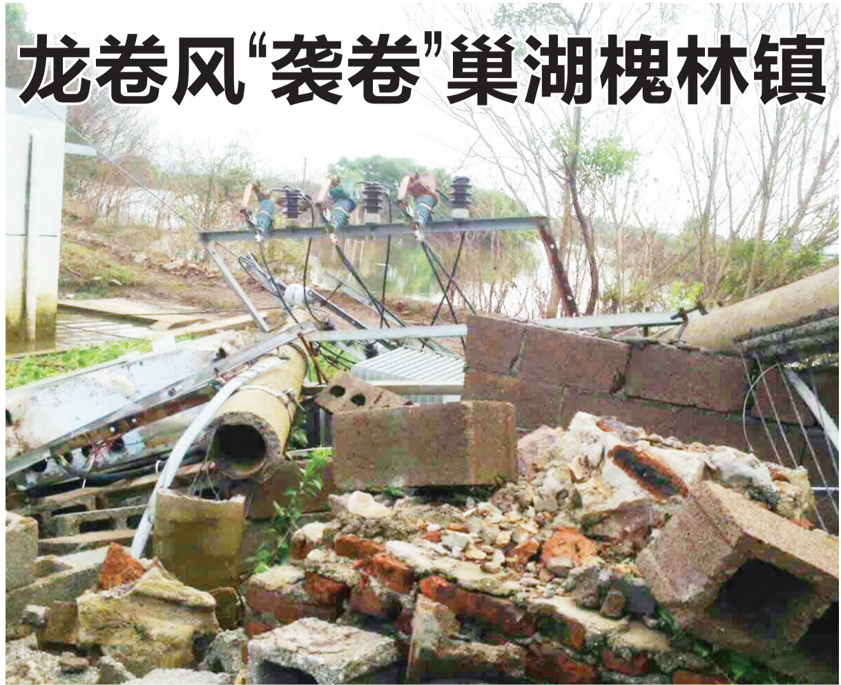
大项自然村排灌站变压器及其配套设施严重损坏
