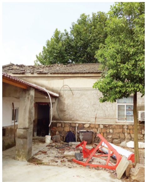
屋顶的太阳能热水器被刮到地面
