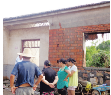
村民房屋顶和门窗被掀
