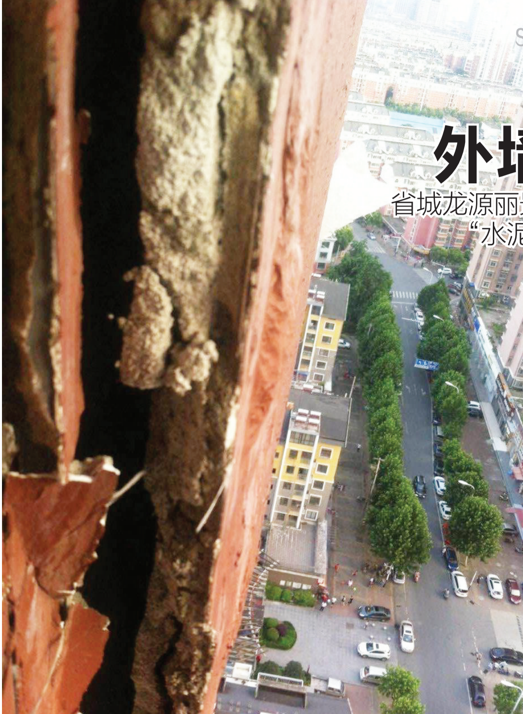
外墙面裂开了大口
