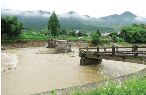
黟县被冲毁的桥梁
