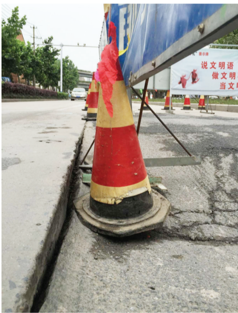
下沉处跟正常路面的落差很明显
