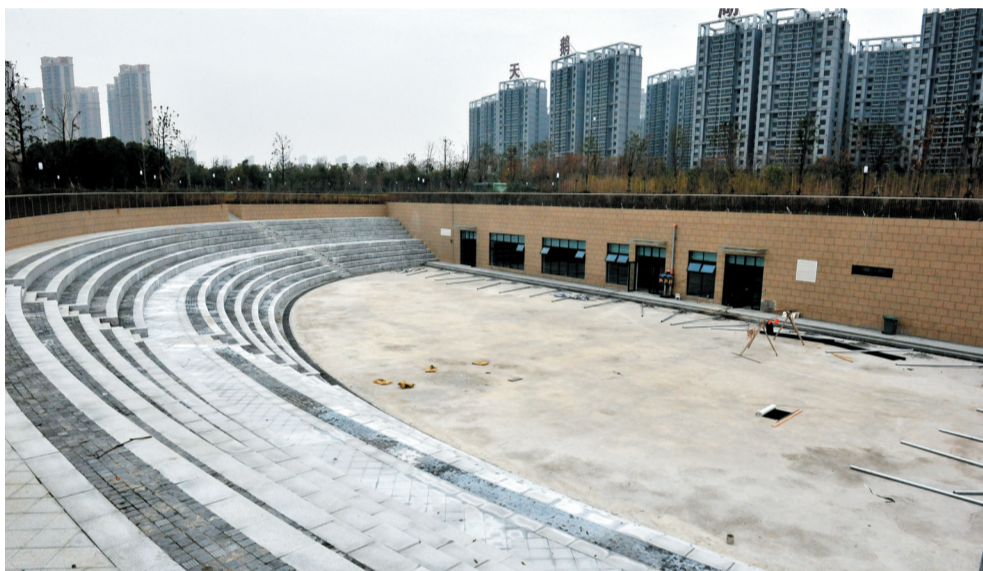
合肥天鹅湖体育公园地下活动中心,室内水电、暖通等安装工作已经完成9成,景观绿化、室内装修、泳池设备已经基本完成,预计今年12月底,整个项目将可以竣工。活动中心总建筑面积为14780平方米,平均埋深6到8米,将能容纳500人同时健身。 记者 倪路/图
