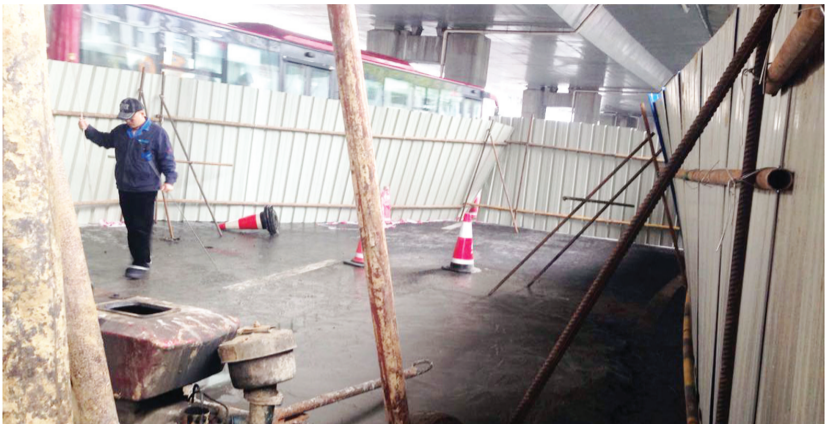
下沉的路面已被施工围挡围起
