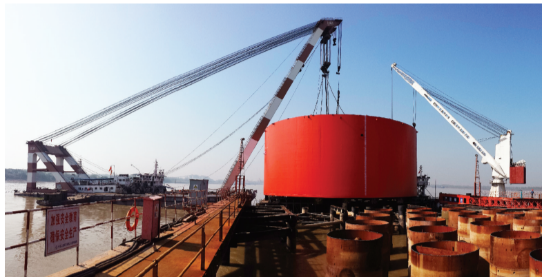
10月25日下午,经过2小时的奋战,芜湖长江公路二桥南主墩内径39米、外径42米、高18米、自重1000多吨的超大钢吊箱围堰吊装成功。据悉,该桥建设周期为4年,有望在2017年建成通车。 金玉生 记者 祝亮 文/图
