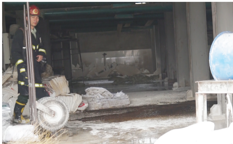
昨日9时14分许,淮北市濉溪县百善镇鲁王面粉厂区内发生爆炸,淮北消防支队先后调派11辆消防车赶赴现场进行救援。经过近两个小时的营救,爆炸引起的大火被扑灭。据了解,事故导致8人受伤,均暂无生命危险。目前,事故原因及损失正在调查中。 李小说 记者 志强 文/图
