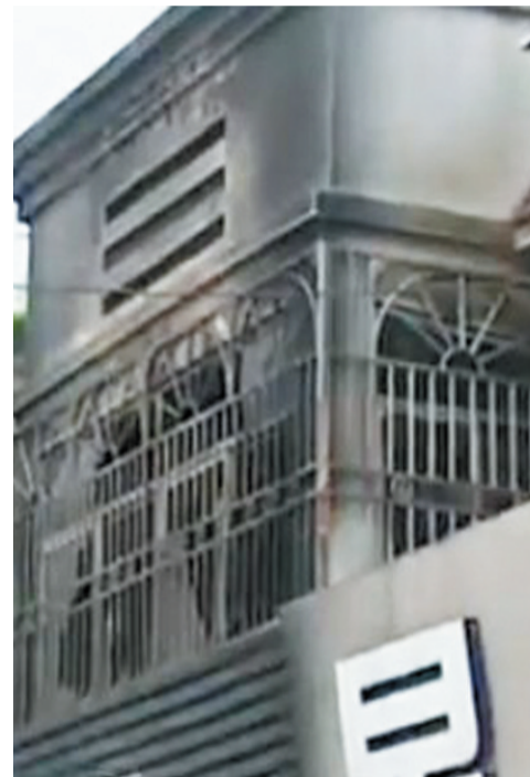
失火房屋2楼防盗窗全被封死
