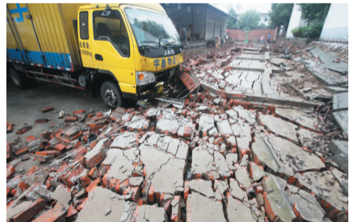
围墙倒塌 货车遭殃
