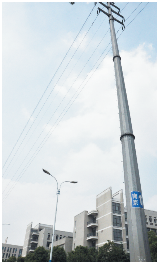
公寓楼旁边架着高压线
