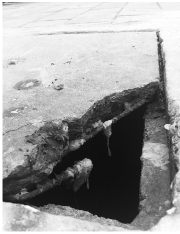
宁国新村断裂的化粪池盖
