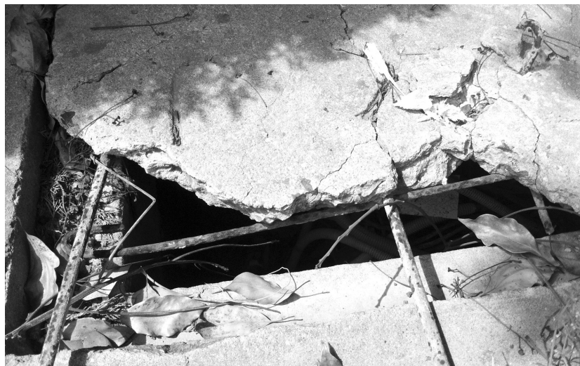
世纪阳光花园摇摇欲坠的窨井盖
