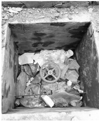
青年小区多处出现窨井缺失现象
