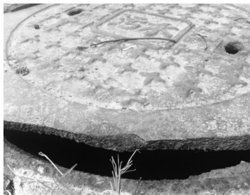
太宁花园一断裂的污水窨井盖
