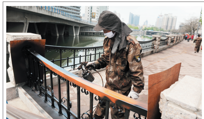
昨日上午,南淝河长江路桥头边,几名工人在用喷枪对南淝河岸边的栏杆进行喷漆翻新。此次养护施工主要集中在维护长江路桥至屯溪路桥沿岸护栏,预计两到三日内可结束施工。 记者 黄洋洋/图
