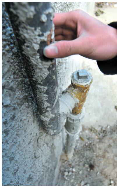
地面喷出的泥浆溅到煤气管道和墙面上
