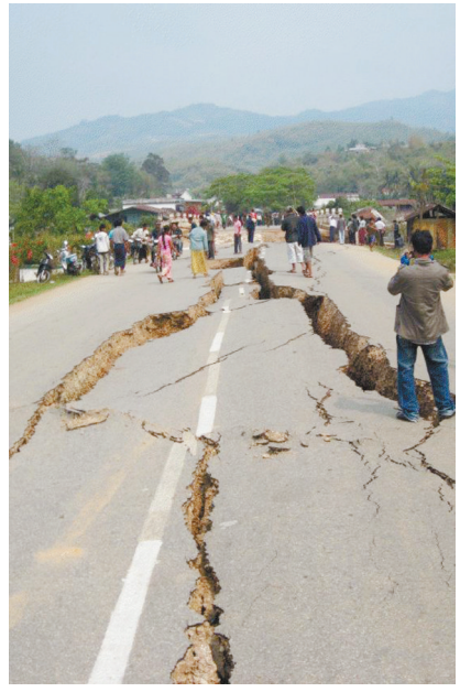
缅甸东北部城市公路在震后出现裂痕
