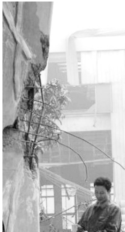
被砸坏的桥墩,钢筋都裸露了出来
