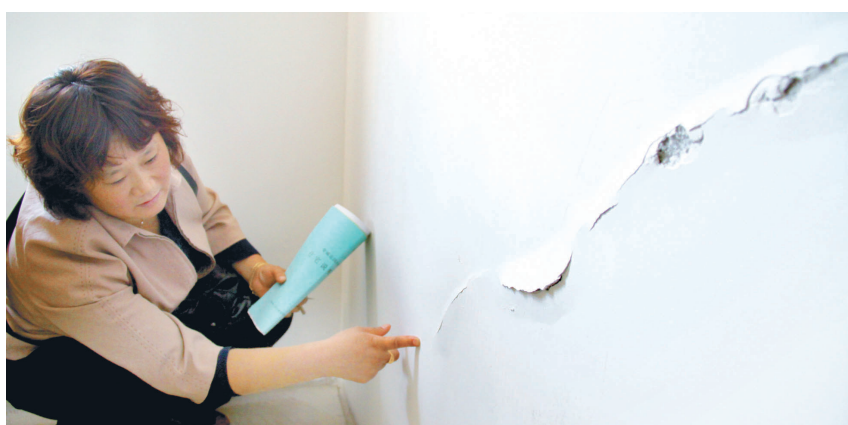
任大姐指着因漏水裂开的墙壁
