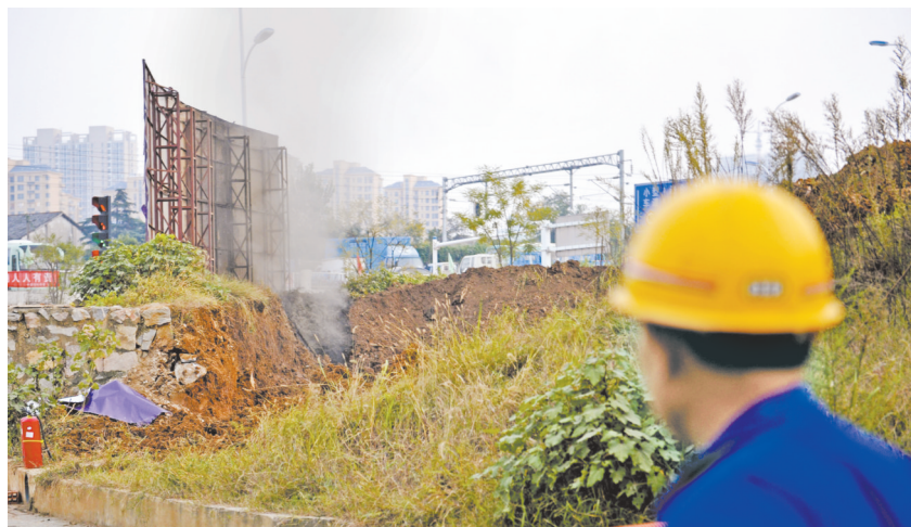
被挖爆的燃气管射出冲天气浪
