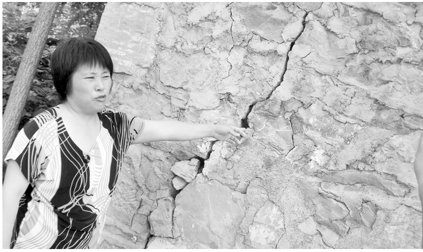
这房子已成危房了
