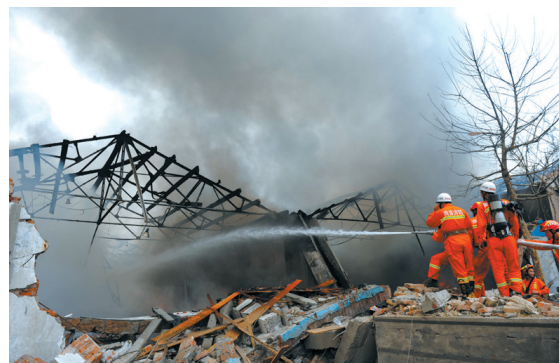
消防队员正在现场灭火
