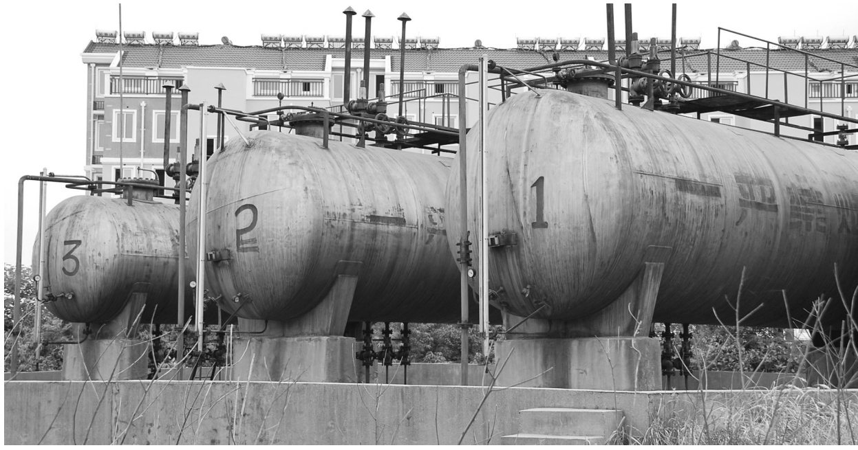
硕大的储气罐与居民区近在咫尺
